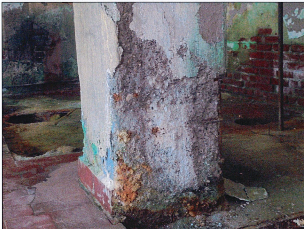
Abb. 16: Detailansicht des korrodierten Pfeilers, Nickelbad 2
