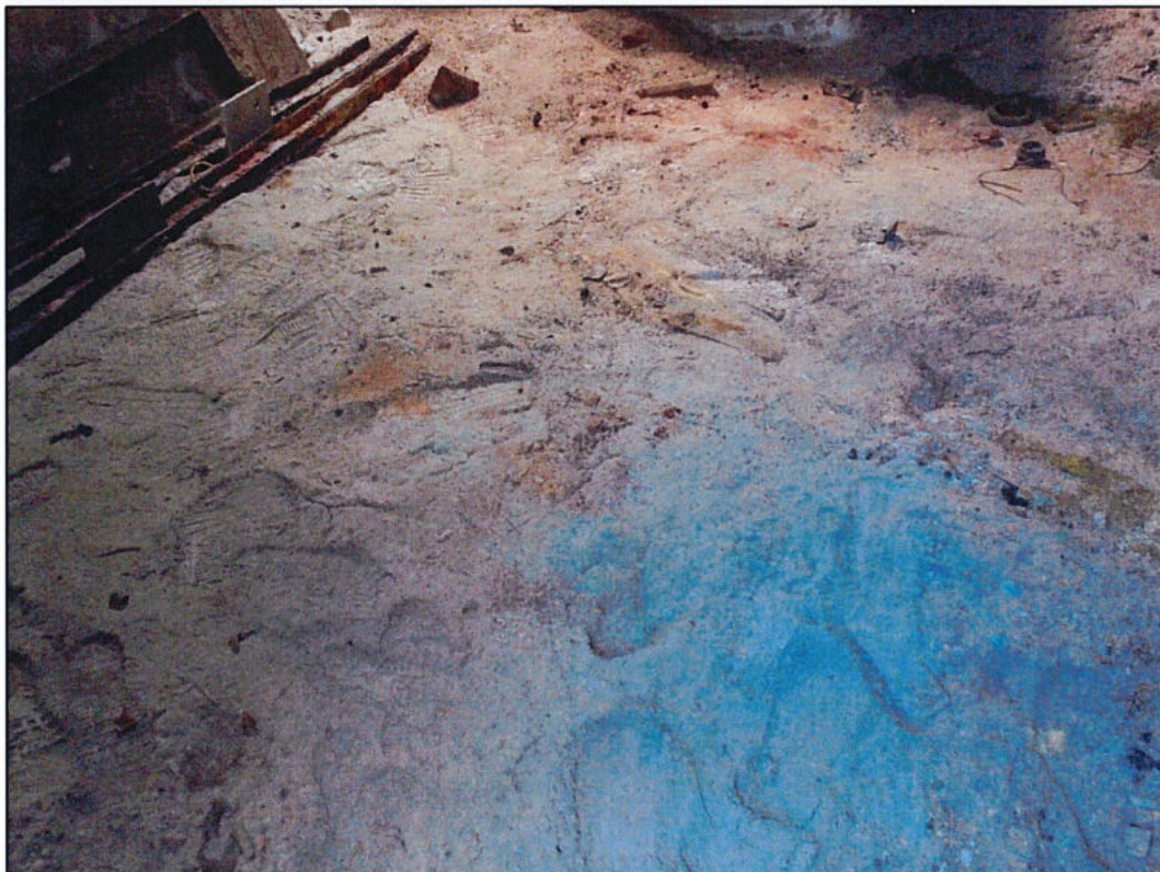
Abb. 8: Schüttung auf dem Boden der Kläranlage
