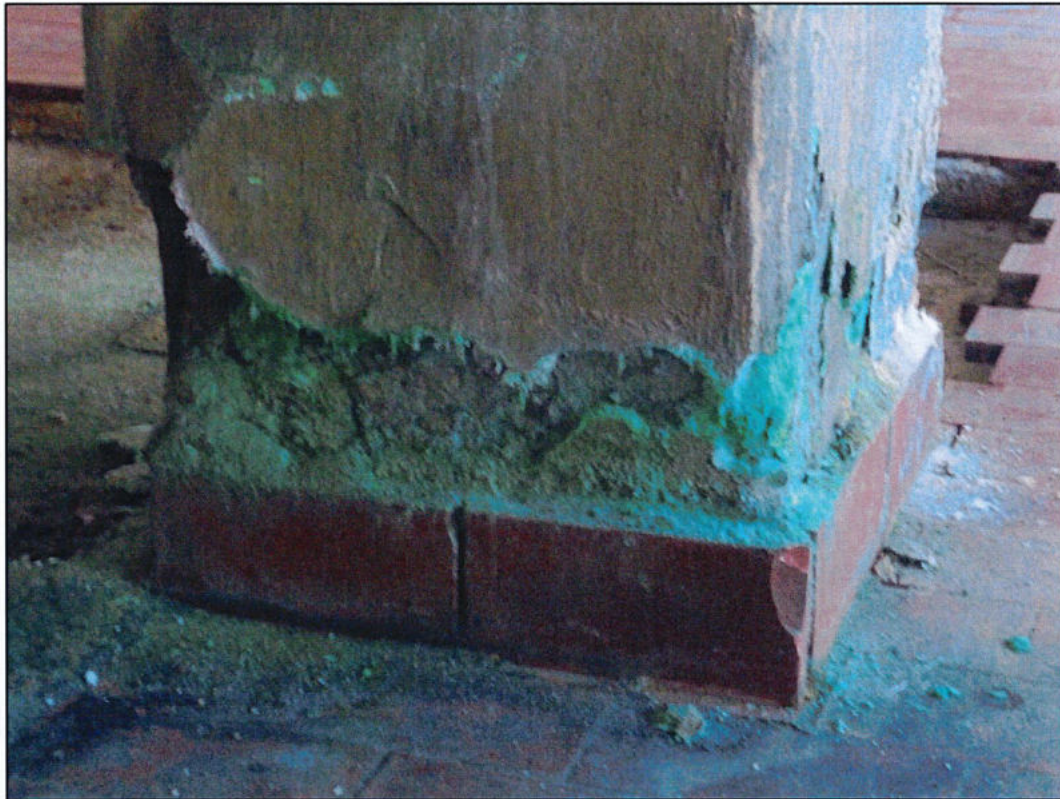
Abb. 13: Detailansicht des korrodierten Pfeilers, Nickelbad 2
